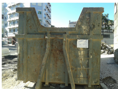
Figura 13 – Contentores para colocação de resíduos de ferro e aço.
